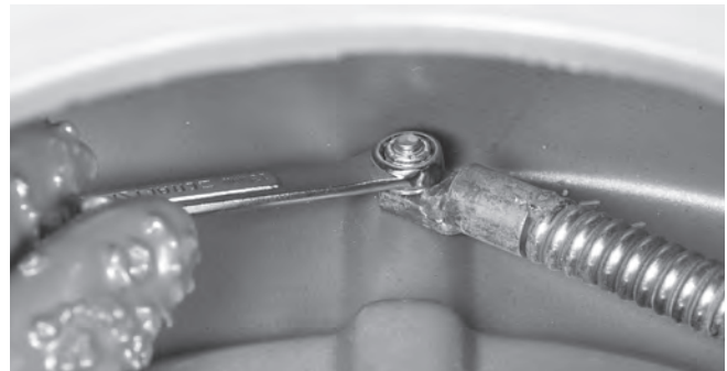
Figura 30 – Perno de anclaje del acoplamiento flexible pigtail
